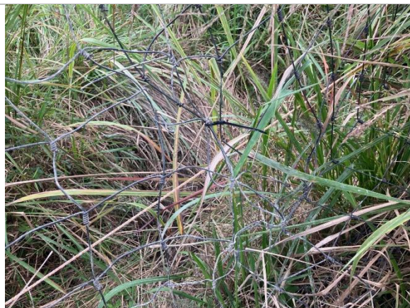
J) フェンス格子の針金が外れたとみられる。(簡易補修を実施)
