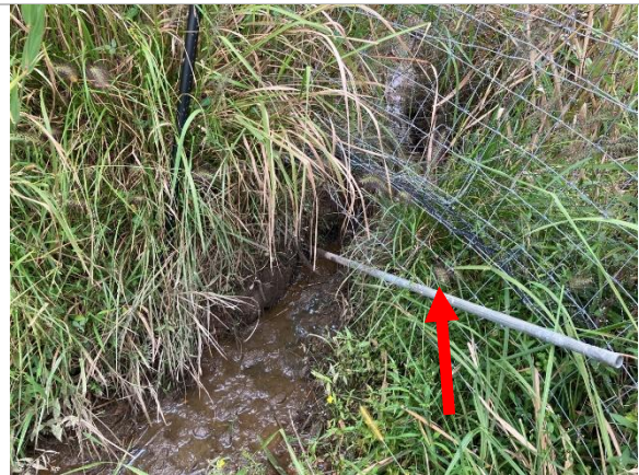
G) フェンス下部から水路伝いに侵入
