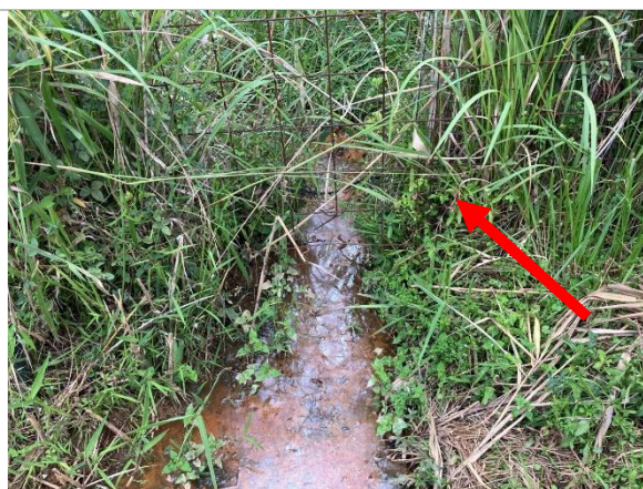
H) 過去に侵入されワイヤーマッシュで補強している。
