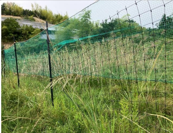
C) フェンス変形・侵入・補強している様子
