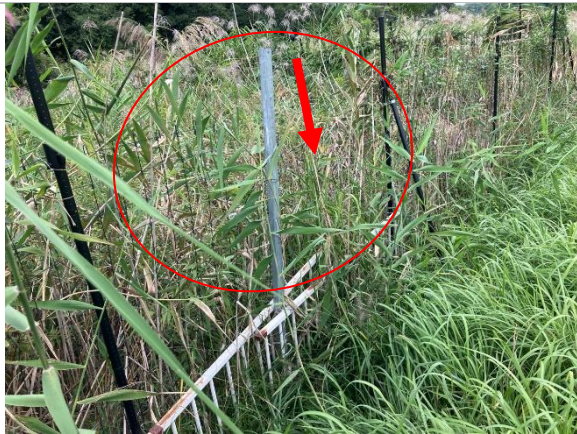
C) フェンス破損（結合部の外れ）
