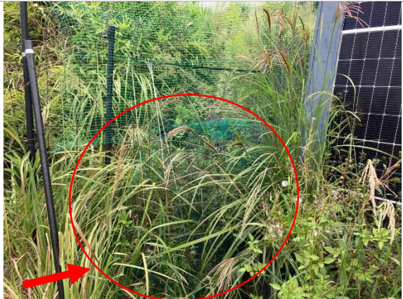
E) 太陽光パネル付近のフェンス破損にワイヤーメッシュを充てて簡易補強している。
