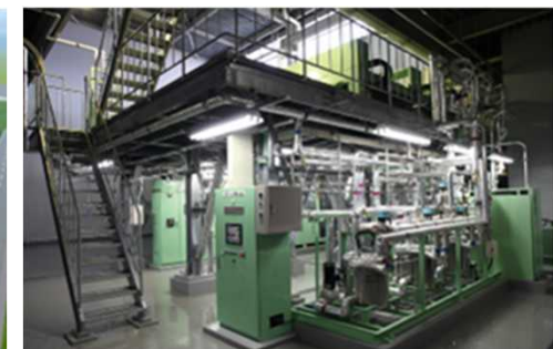
【臨界抽出プラント装置】
