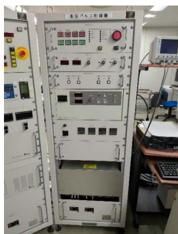
高圧パルス制御盤
