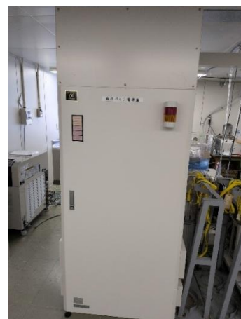
高圧パルス電源盤
