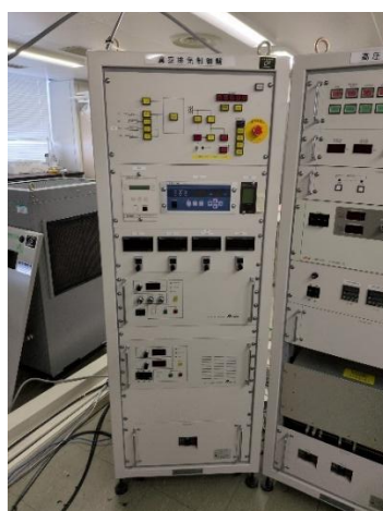
真空排気制御盤
