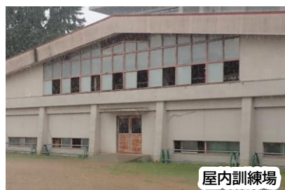
▲老朽化した訓練施設
