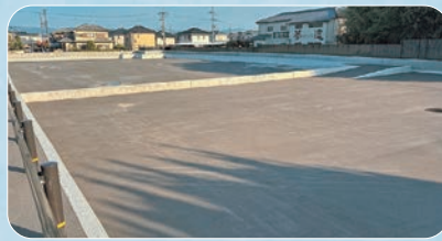
法隆寺北流域貯留施設（斑鳩町） 貯留量 4,500 m 3
