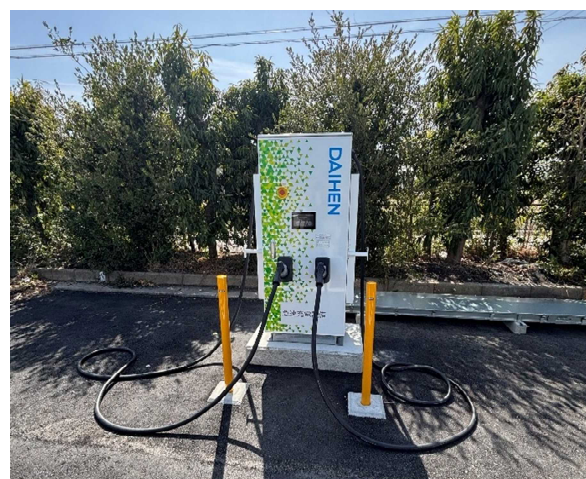
急速充電設備
