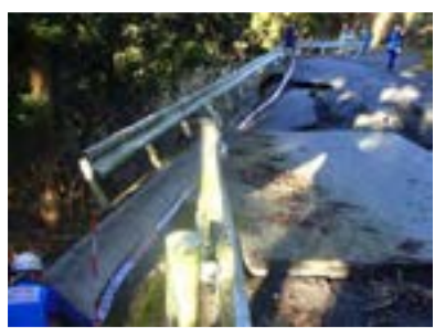
長野県北部地震における調査事例
