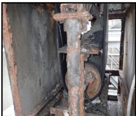
処理施設(焼却炉)
