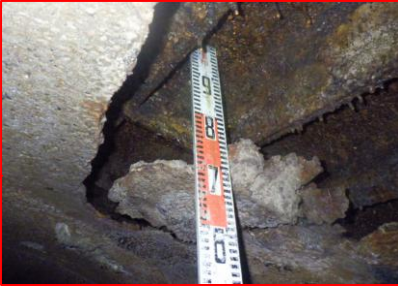
(左写真の損傷部拡大)
