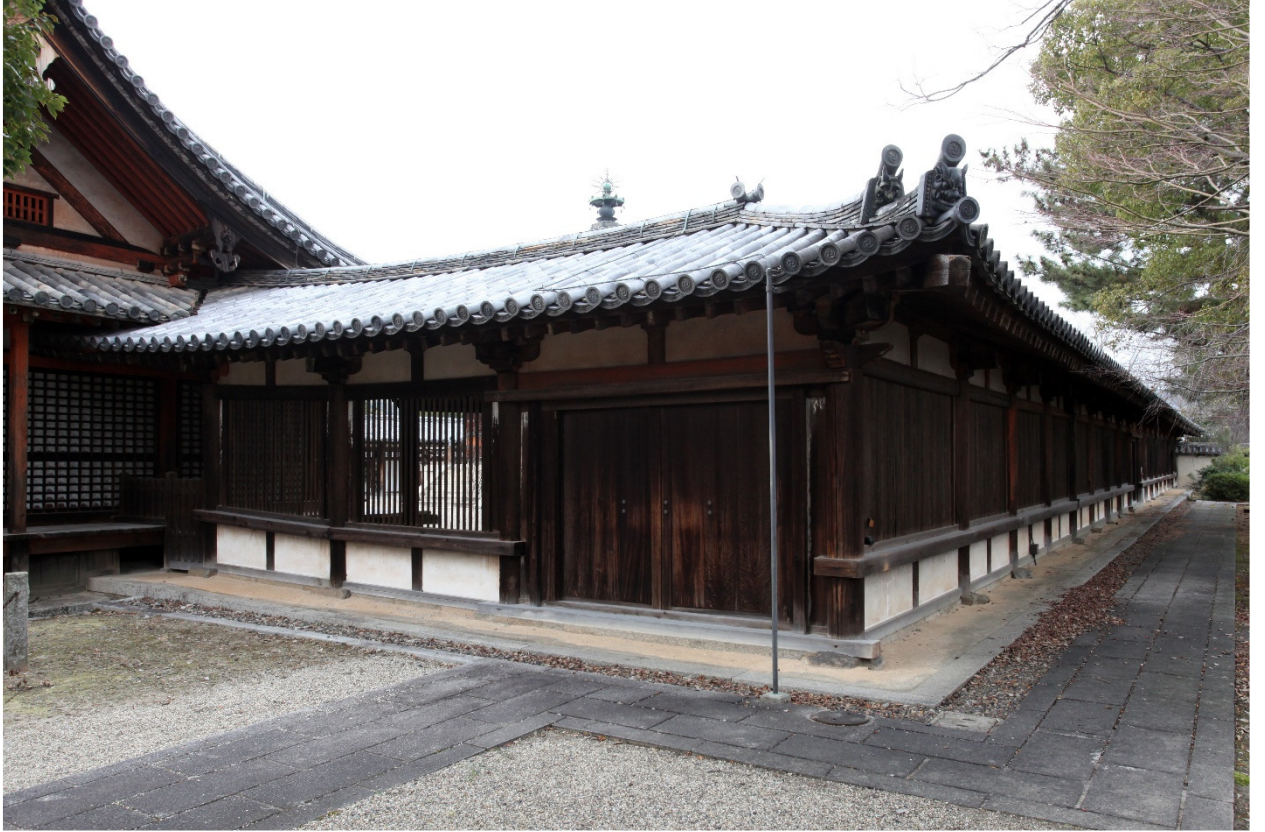
重要文化財法隆寺東院廻廊 東廻廊 側面 東南より 修理前
