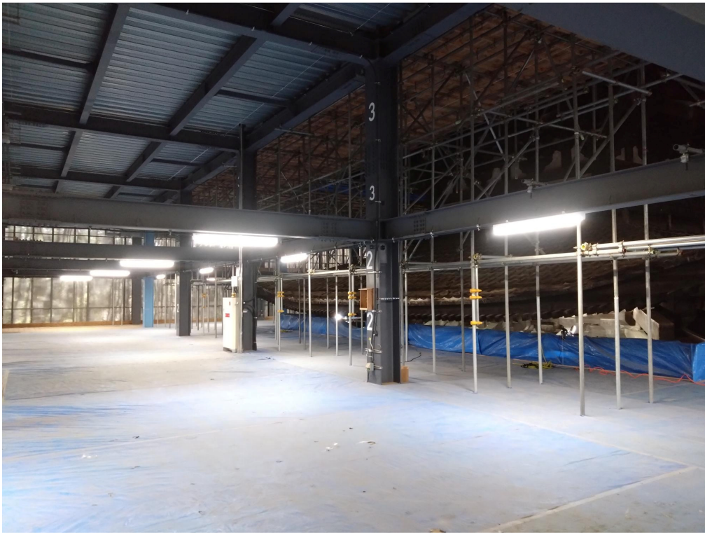
国宝 興福寺五重塔 軒足場 3階 北西から (中間梁に鉄骨を入れる予定)
