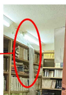
◀雨漏り発生箇所
