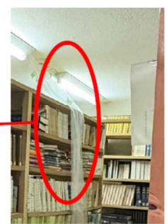
◀雨漏り発生箇所
