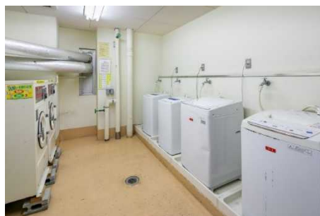
共用ランドリー室
