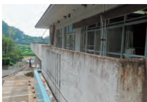
老朽化した施設の外壁
