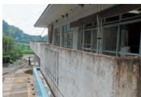
老朽化した施設の外壁
