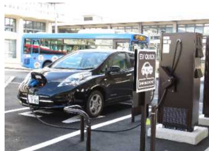
急速充電設備(県本庁舎)
