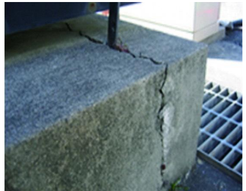
基礎部(基礎のクラック)
