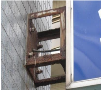
接合部(ブラケットの腐食劣)
