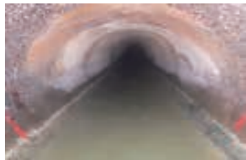
▲老朽化した管渠
