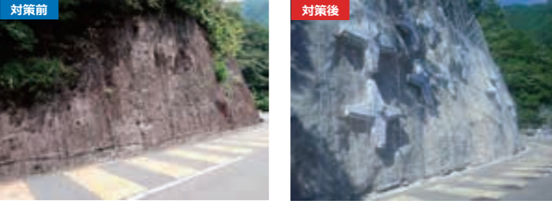
▲コンクリート吹付及びアンカー工による法面対策 (国道168号 十津川村川津)
