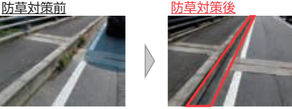
▲防草シールを使用した防草対策 令和7年度 防草対策工事 完了箇所(国道166号 葛城市太田)
