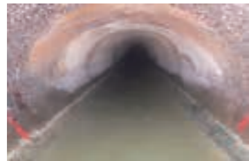
▲老朽化した管渠
