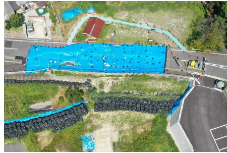
被災直後の状況(三郷町立野南1丁目) (令和7年8月)
