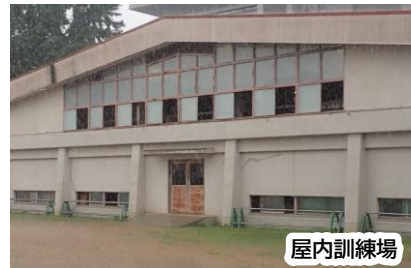
▲老朽化した訓練施設
