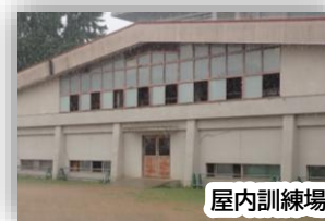
▲老朽化した訓練施設
