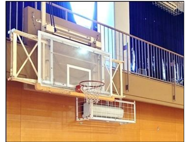
体育館に設置された空調設備
