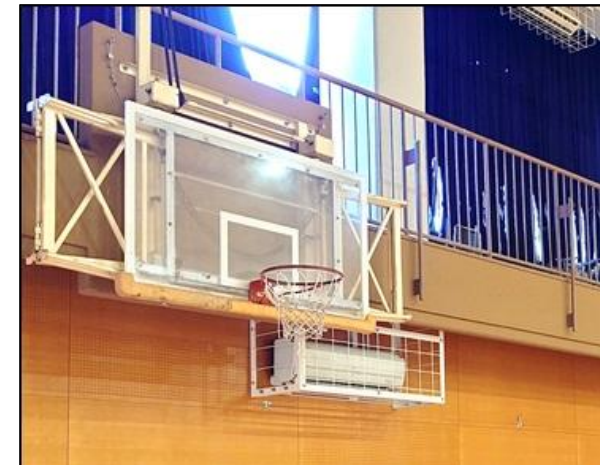
体育館に設置された空調設備
