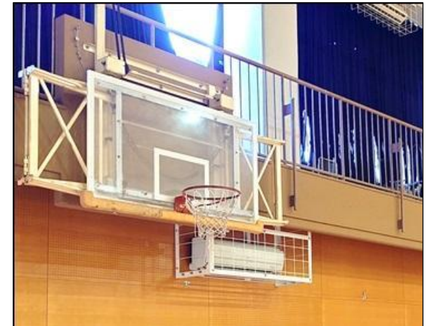
体育館に設置された空調設備
