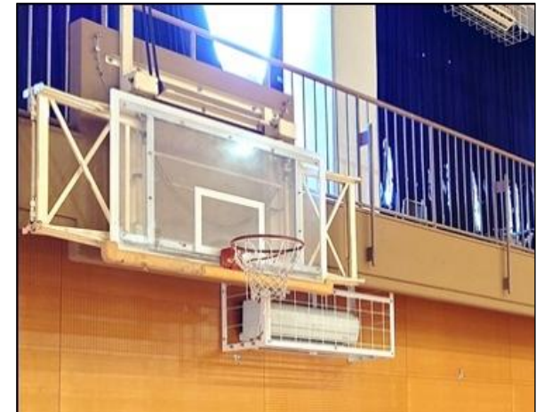
体育館に設置された空調設備
