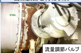
機械設備老朽化状況
