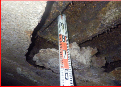
(左写真の損傷部拡大)
