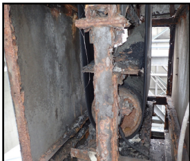
処理施設(焼却炉)
