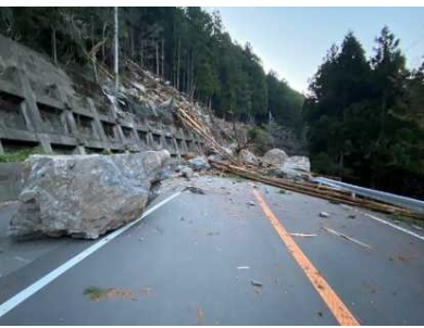
令和5年4月の落石による18日間の通行止め
