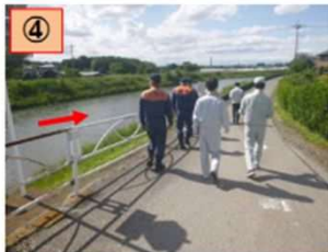
④真岡土木の点検状況(5/24) 一級河川五行川(真岡市大根田)
