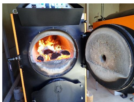
薪ボイラー(天川村)
