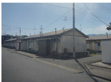
建替予定の老朽化した団地
