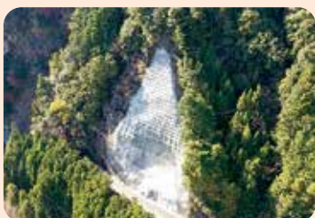
▲法面对策(国道169号 下北山村上池原)
