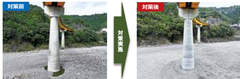
▲橋脚巻立て工による耐震補強工事（一般国道168号 小原大橋）
